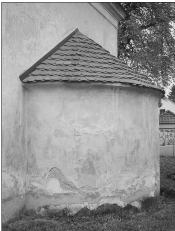
Obr. 56. Ondřejov u Prahy, kostel sv. Šimona a Judy. Jižní strana apsidy považované dosud mylně za indicii původně románského založení kostela. Stav v říjnu 2009 před stavbou odvodnění a následnou opravou fasády
